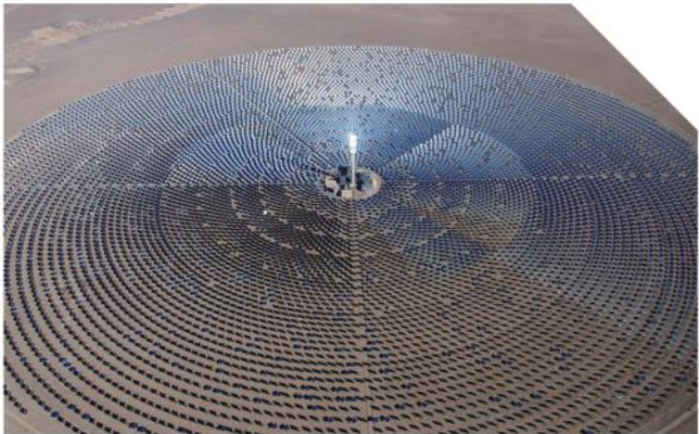
塔式聚光系统 Solar Tower CPV System
